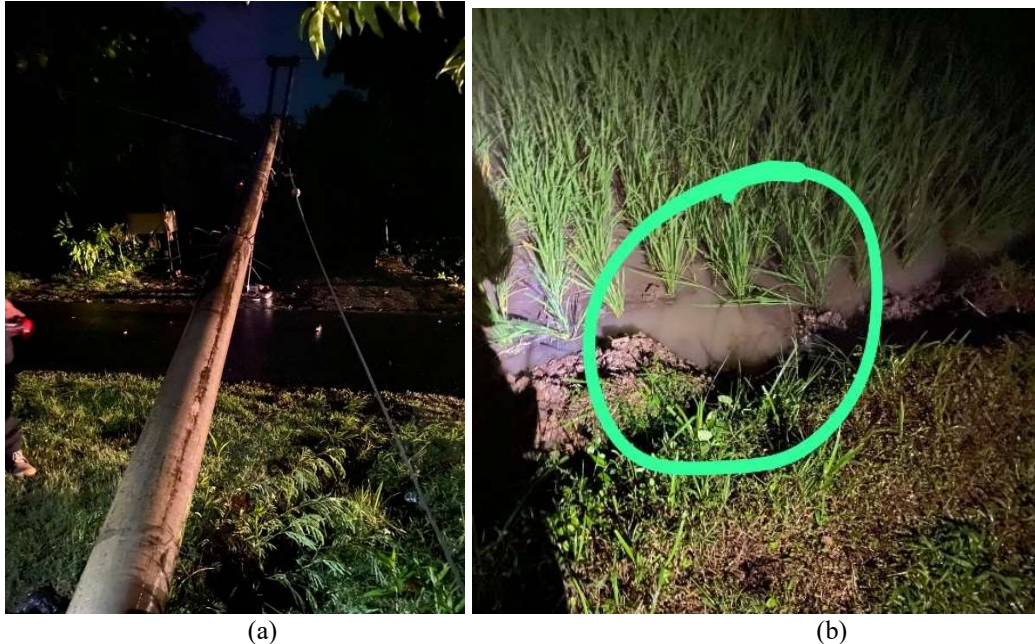
Gambar 10. (a)Tiang NA0185 A7 Rubuh Pada Saat Hujan Sangat Lebat dan Angin Kencang, (b) Beton Blok Plat Angker Terangkat
