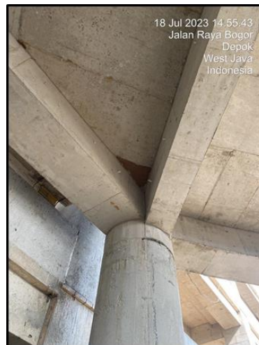
Gambar 11. Bekisting yang tertinggal
