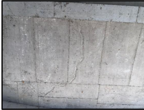
Gambar 10. Keretakan pada Pelat Ramp
